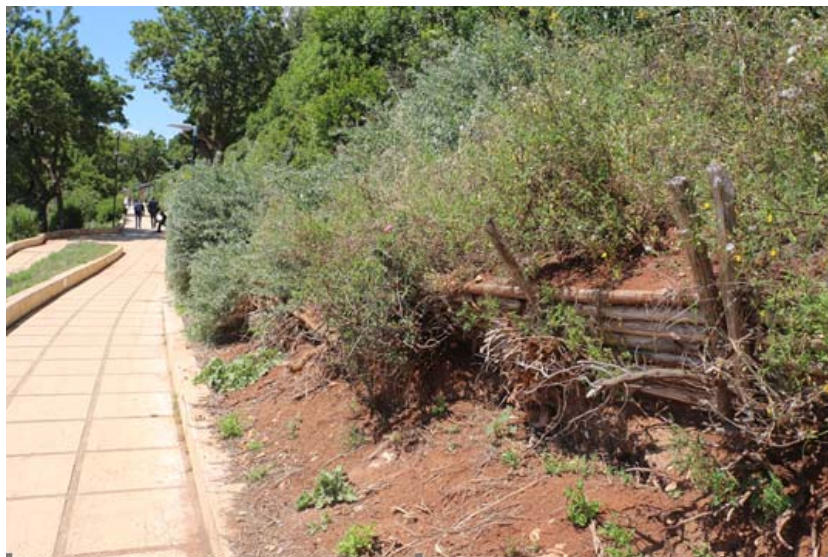
Figura 3.5 – Lo scivolamento dei materiali ha interessato la strada interna al lungomare provocando smottamenti di piccole dimensioni,.
