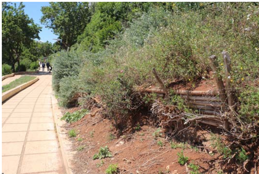
Figura 4.8 – Lo scivolamento dei materiali ha interessato la strada interna al lungomare provocando smottamenti di piccole dimensioni.
